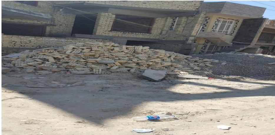
صورة رقم ( 3 ) تمثل التعديت والممارسات على الشوارع والازقة في حي المتنبى المصدر / الباحث
